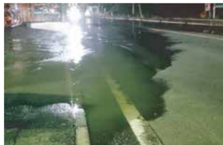
石綿セメント管の破損
